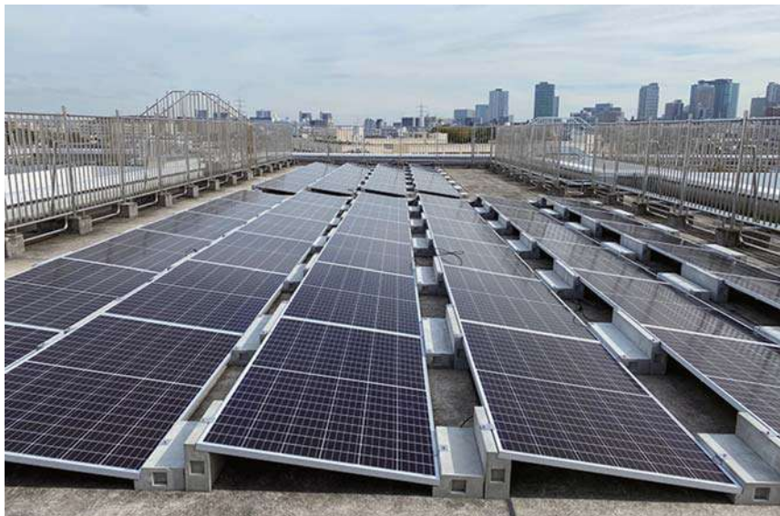
横浜市が東京ガス株式会社と契約し PPA 事業で設置された新鶴見小学校（鶴見区江ヶ崎町）の太陽光発電設備＝横浜市提供
